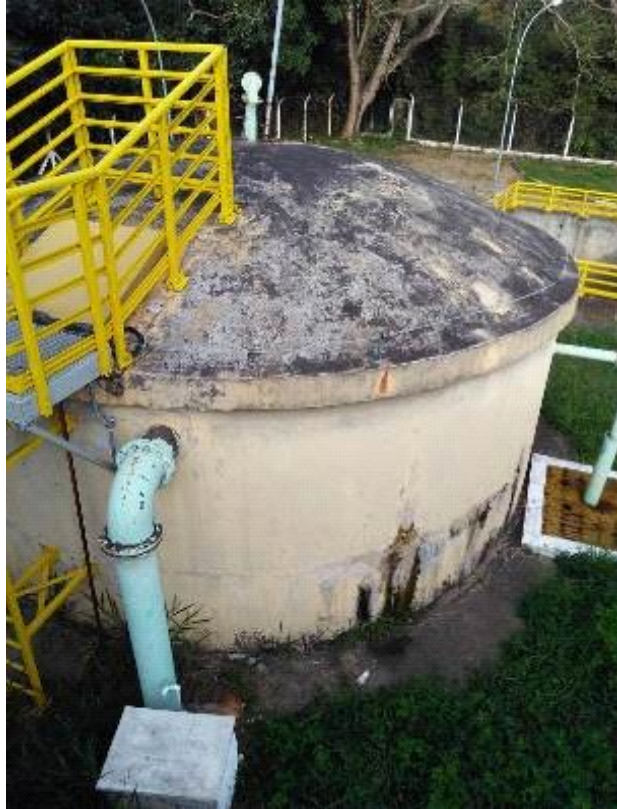
Foto 34 ETA São Silvestre - Reservatório apoiado de passagem
