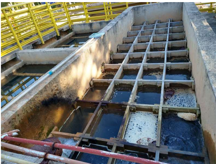
Foto 15 Vista geral dos flocladores hidráulicos, à direita, e decantadores, à esquerda
