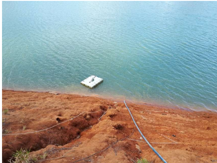
Foto 22 Vista da Captação Flutuante
