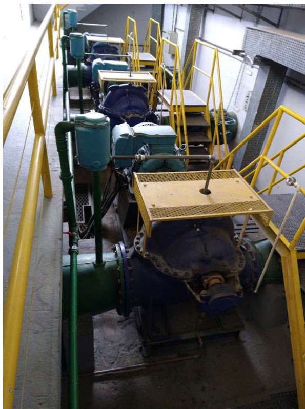
Foto 4 vista do poço seco e conjuntos motobomba, do tipo bipartidos, da captação principal.
