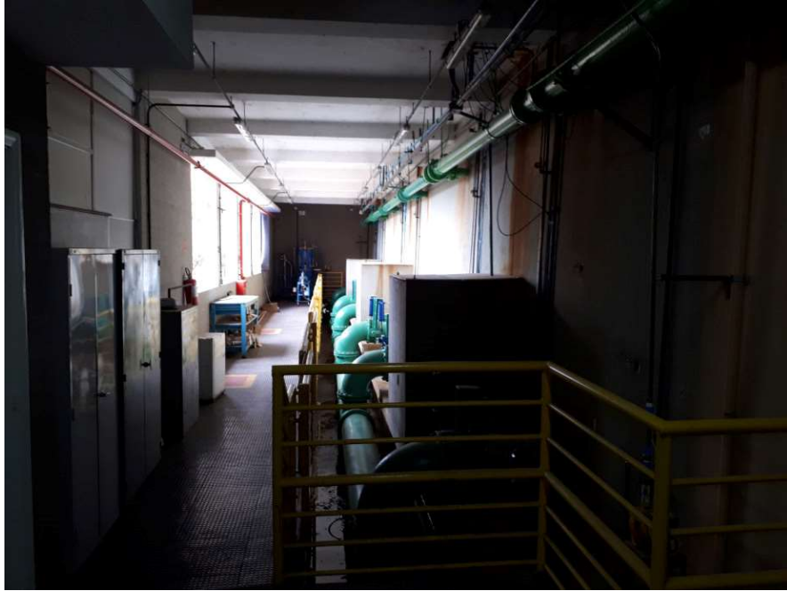
Foto 10 Galeria do barrilete dos filtros e caixas de controle de nível.
