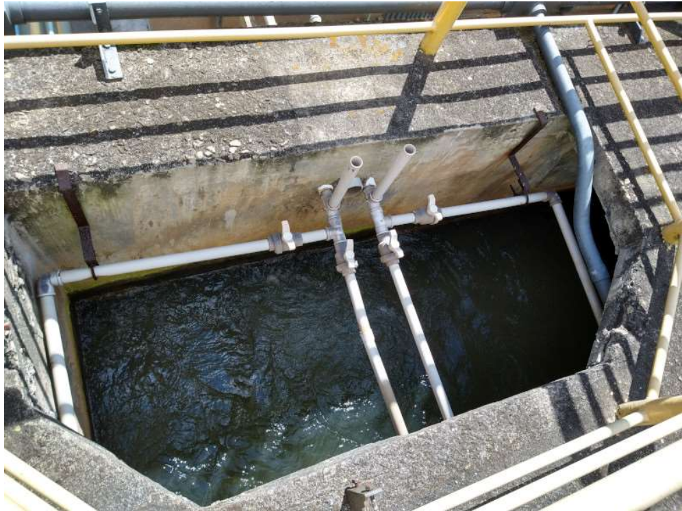
Foto 6 Vista da estrutura de chegada de água bruta e tubulações de aplicação de produtos químicos
