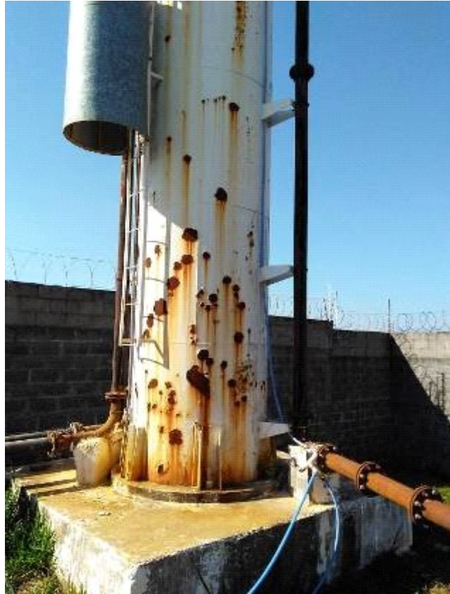
Foto 36 Centro de Reservação Jardim Paraíso - R73
