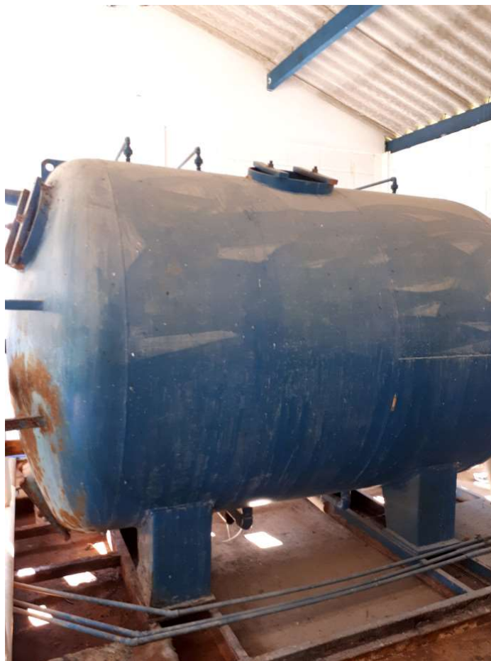
Foto 32 Vista do filtro horizontal sob pressão
