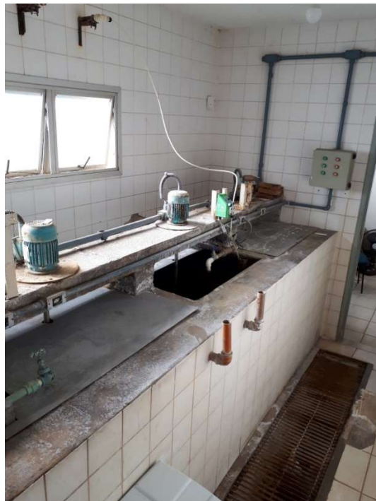
Foto 19 Sala de preparo e dosagem de barrilha
