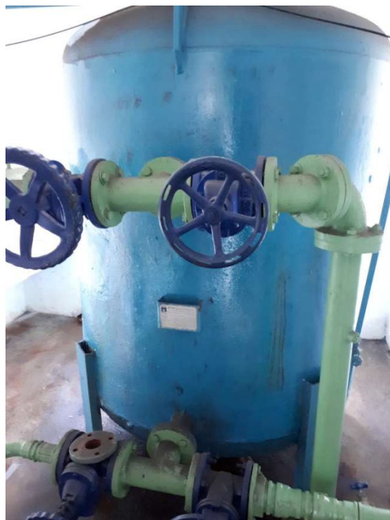
Foto 23 Vista do filtro rápido sobre pressão
