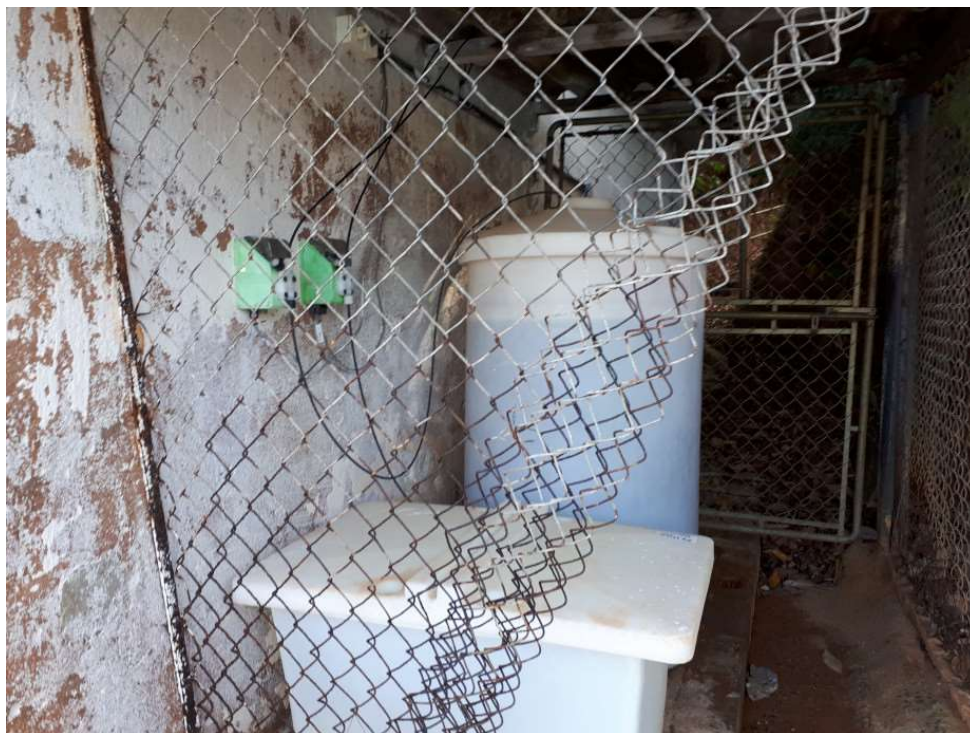
Foto 24 Vista dos sistemas de armazenamento e dosagem de hipoclorito de sódio e ácido fluossilícico.
