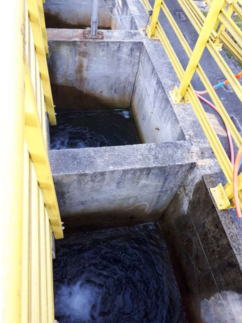
Foto 17 Vista geral dos filtros
