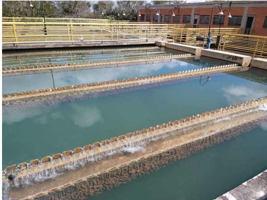
Foto 8 Vista da porção final de um dos decantadores com destaque para as calhas de coleta de água decantada
