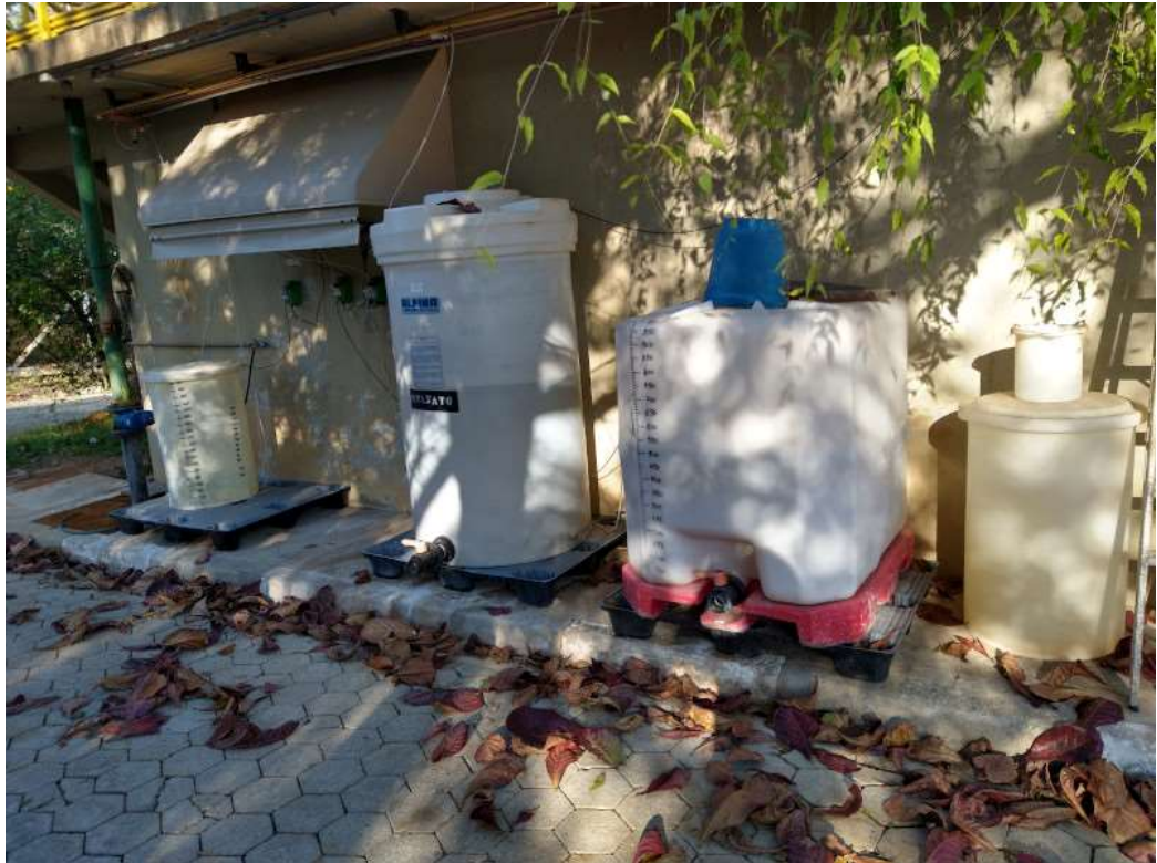
Foto 18 Vista geral dos sistemas de armazenemto e dosagem de produtos químicos: sulfato de alumínio, hipoclorito de sódio e ácido fluossilícico
