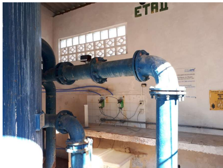
Foto 27 Vista parcial do filtro da ETA II a sistemas de dosagem de hipoclorito de sódio e ácido fluossilícico
