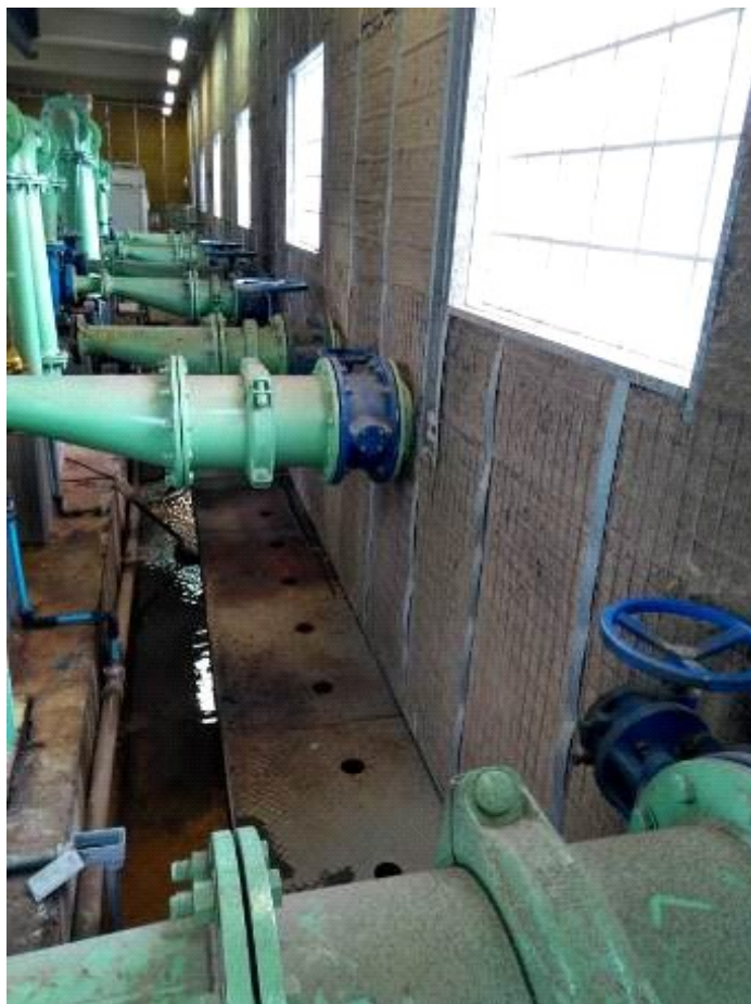
Foto 40 EEA Diogo Fontes - Registros de manobra emperrados
