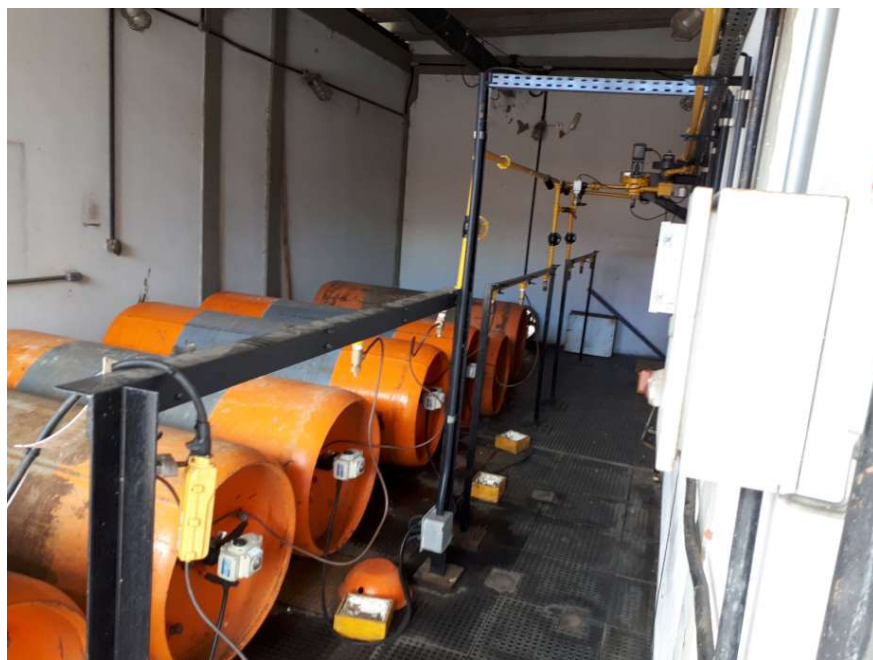
Foto 13 Cilindros de 900 kg para o armazenamento do cloro gasoso
