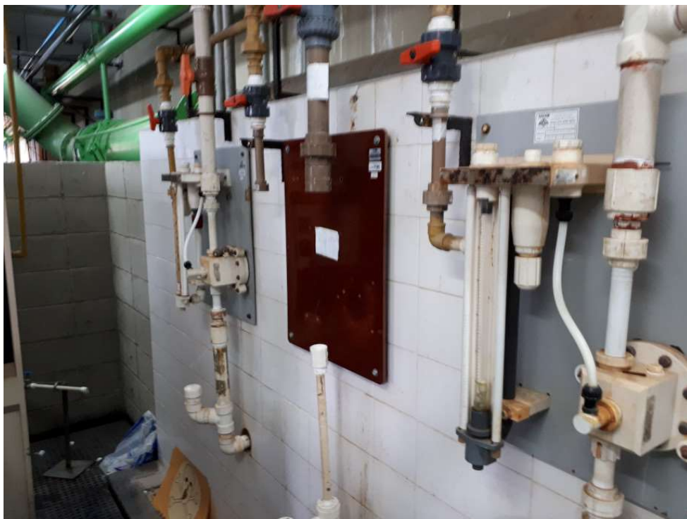
Foto 14 Dosadores de cloro gasoso
