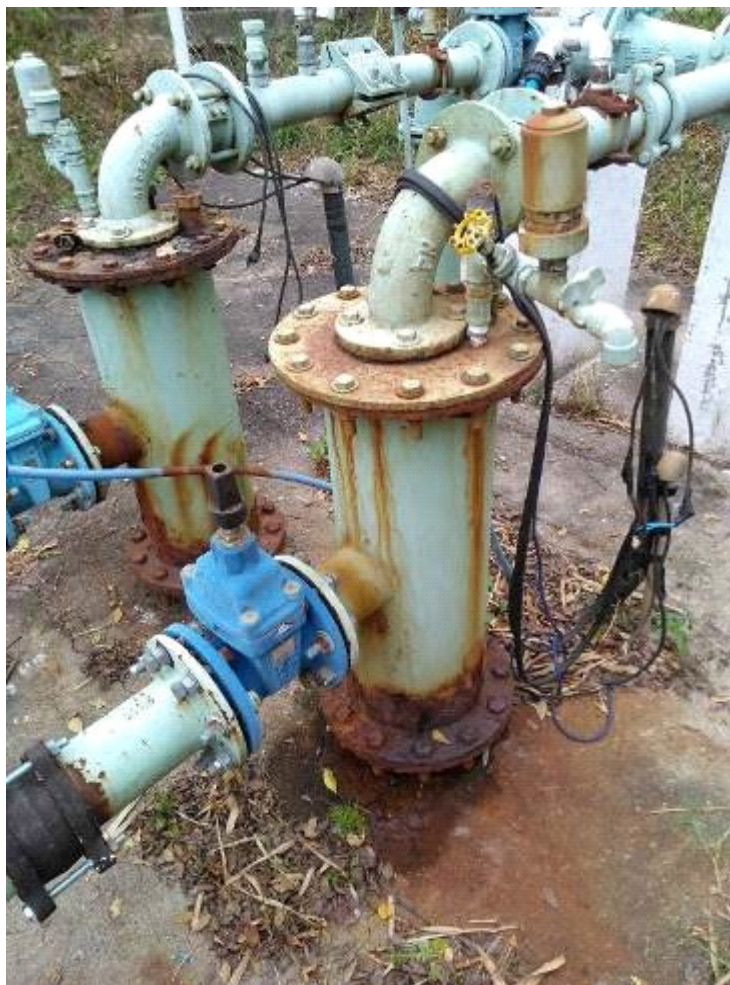
Foto 42 “booster” Jardim Terras de São João - Bombas
