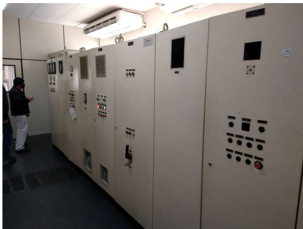
Foto 5 Vista dos painéis de energização e comando dos conjuntos motobomba da captação principal.
