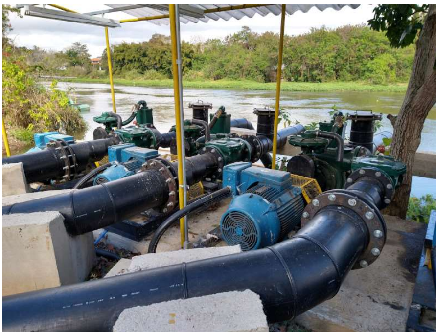
Foto 1 Vista da captação auxiliar mais nova, fixa na margem
