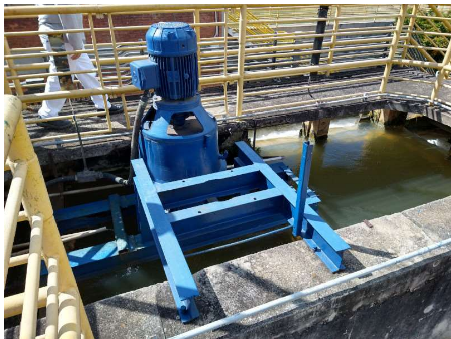
Foto 7 Vista de um dos floculadores mecânicos desativados
